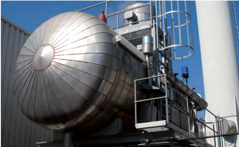
Entgasungsanlage vor dem Heizwerk mit Entgasungsdom.
