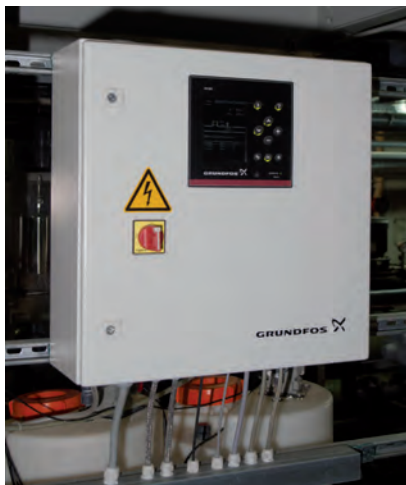
Über die Control MPC-E 2x5.5E wird die Anlage so gesteuert, dass die Pumpen stets innerhalb der Kennlinie laufen, 24 Std. / ca. 360 Tage / Jahr.
