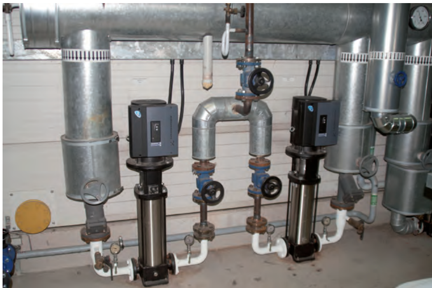
Durch den kavitationsfreien Betrieb wird die Lebensdauer der Pumpen erhöht und der Reparaturbedarf gesenkt. Eingesetzt wurden im Dampfheizwerk Nordstemmen zwei CRE 10-16.
