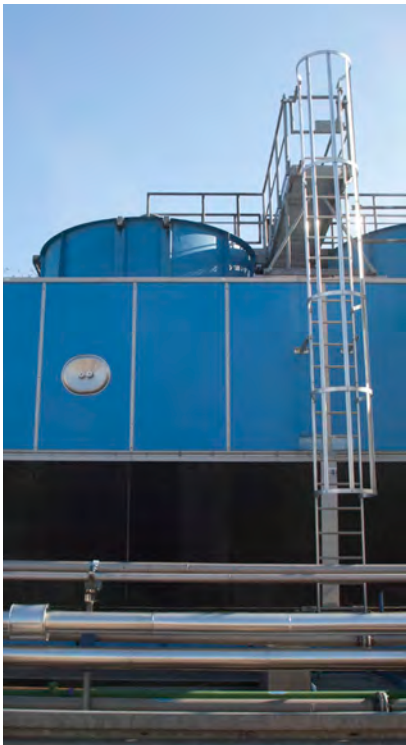
Kühlturm mit darunter befindlichem Auffangbecken.
