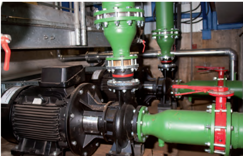
3 Grundfos Kühlwasserpumpen NB 100-200 mit externem Frequenzumformer.
